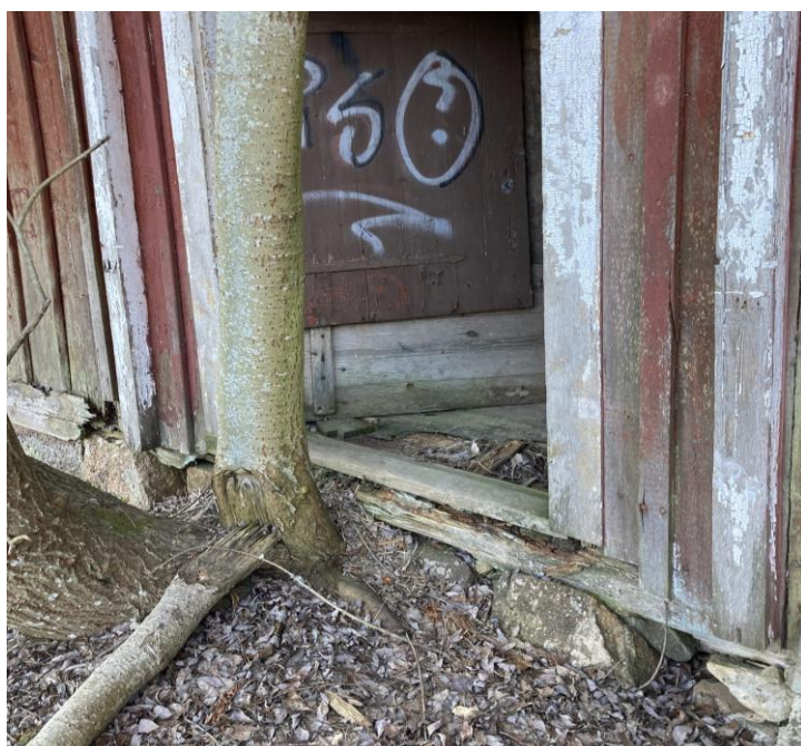
Figur 12 Fuktproblematik vid mangårdsbyggnadens entré
